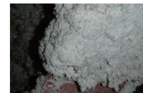
吹付け石綿の例
